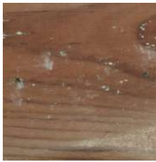
Surface mould/Moho superficial/ Moississures superficielles/ Oberflächlicher Moder/Muf fa su- perficiële/Oppervlakte-schimmel/ Bolor superficial
