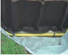
Peripheral drainage Drenaje periférico Drain périphérique Periphäre Drainage Drenaggio periferico Perifere afwatering Drenagem periférica
